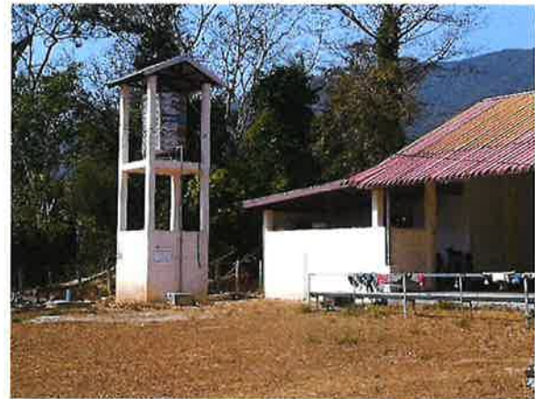
Château d'eau installé en 2018 dans l'école maternelle de Phone construite en 2013
